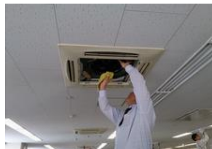
部署ごとにエアコンフィルターの 清掃を定期的に行っています。
